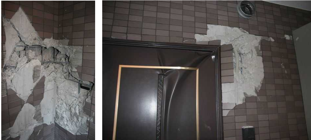
写真 7.4.1 福岡市内に建つ耐震マンションの被害
