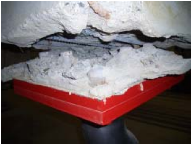
写真 1 破損した免震部材取り付け部
